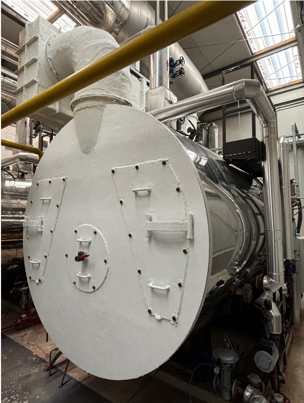
Izolované části kotle a ekonomizéru
